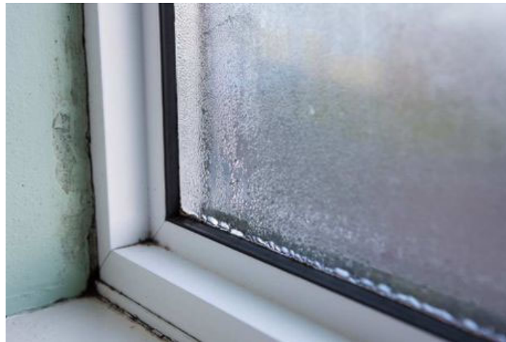
Condens op glas, schimmel op muur
